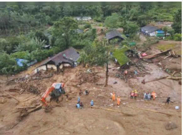
তিরুবনন্তপুরম/ওয়ানাড়, ৭ জুলাই (আইএনএস)। কেরলের ওয়ানাড় জেলার আনাকামপোয়িল-কাল্লাডিটানেল সড়ক প্রকল্প এলাকায় ডয়াহব মাটিগিষে একজন নির্মাণশ্রমিকের মৃত্যু হয়েছে। আহত হয়েছেন সাতজন এবং এখনও সাতজন নিখোঁজ রয়েছেন বলে মঙ্গলবার জানিয়েছেন রাজ্যের মুখ্যমন্ত্রী ডি. ডি. সতীশন। তিনি ঘটনাটিকে 'আতঙ্ক দূর্যোগজনক ট্রাজেডি' বলে অভিহিত করেছেন।
